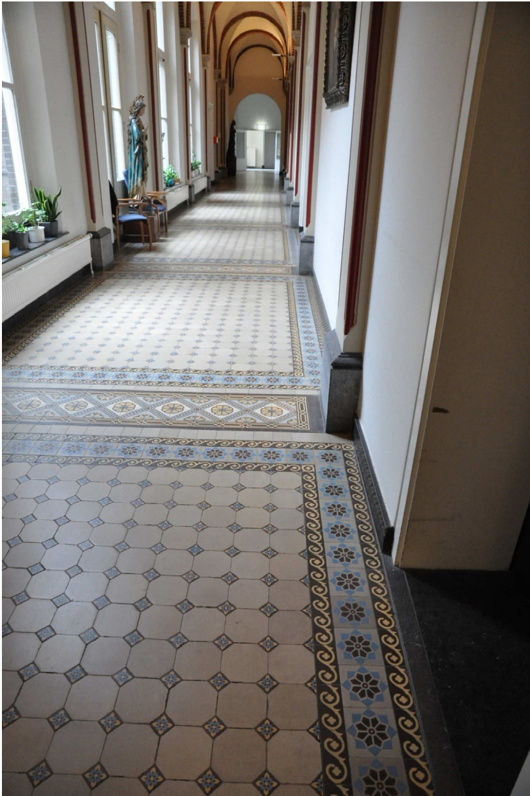
87 Detail van de vloer- en wandafwerkingen in de gang van de middenvleugel, gezien richting het zuiden.
