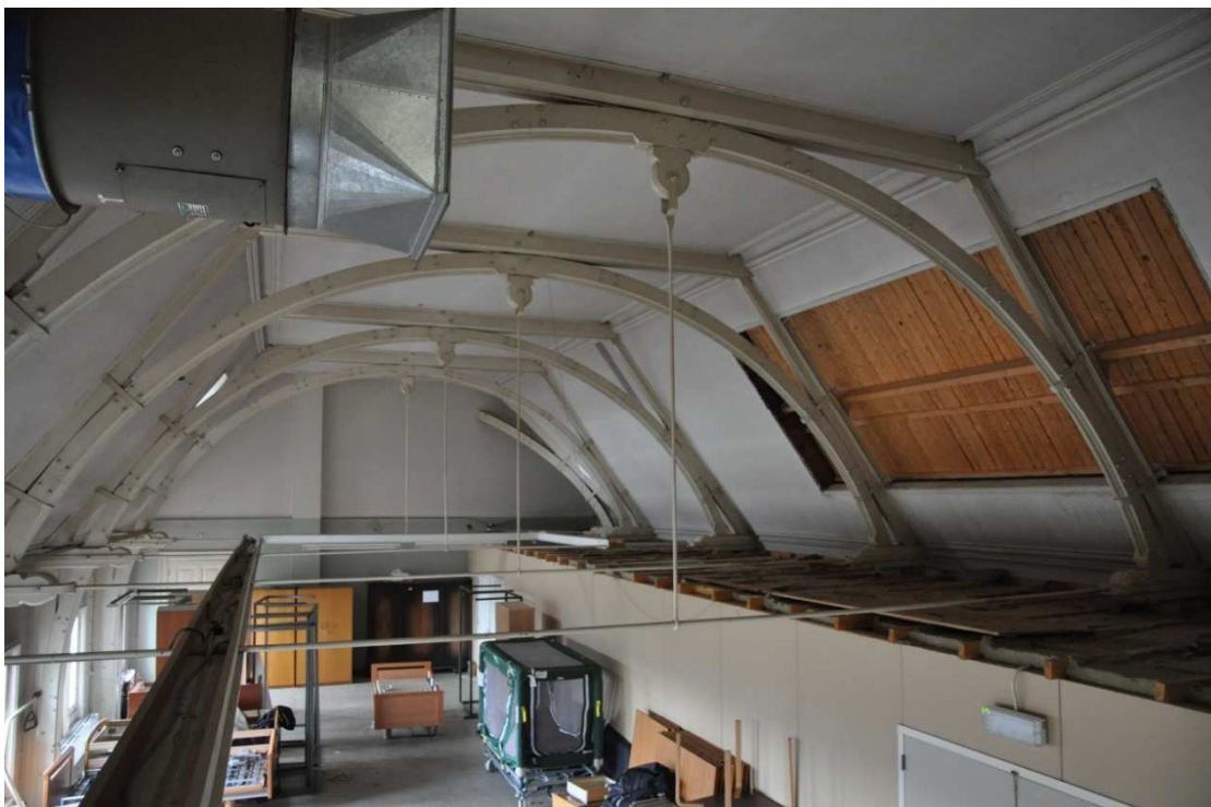
107 De zolderverdieping van de oostvleugel met zicht op de kapsantten, gezien naar het zuiden. Rechts de inbouw van een latere gang op dit niveau, met platte afdekking.
