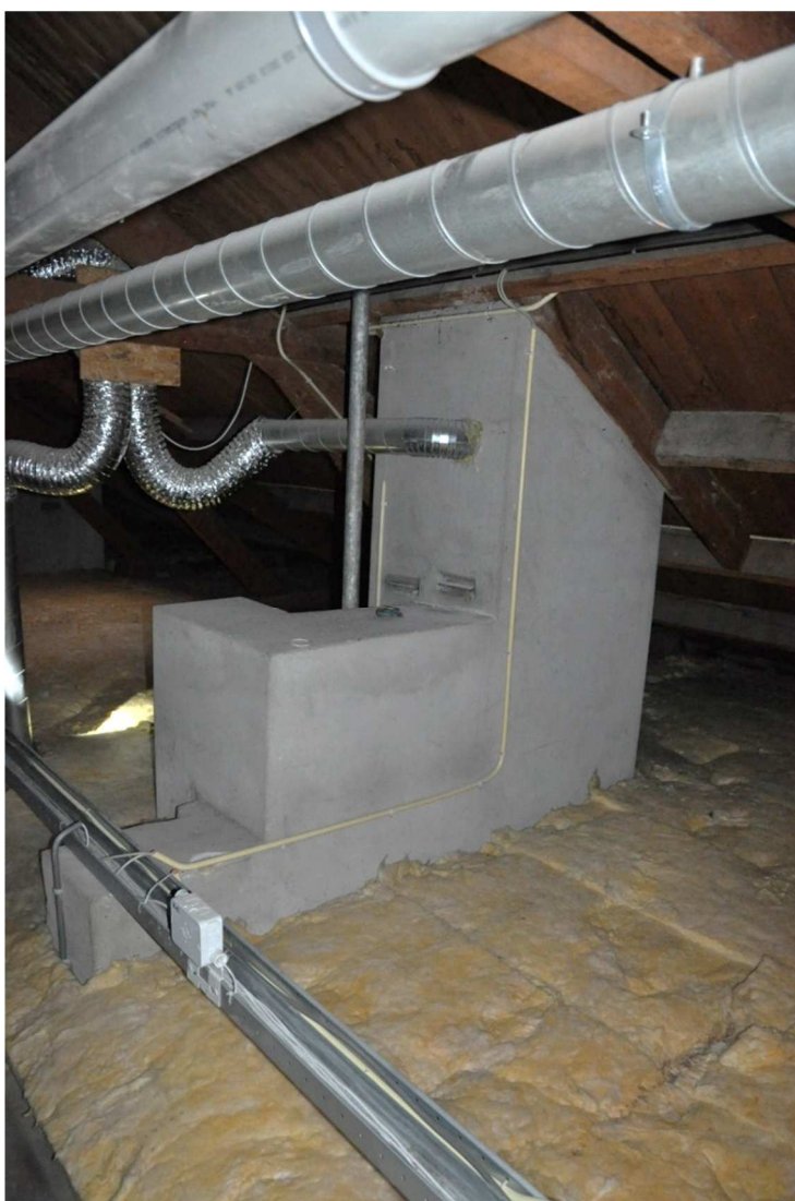
163 Oude ventilatieschacht met later aangebrachte metalen ventilatiekanalen.
